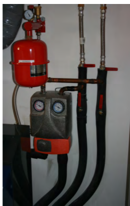
Les 2 vannes de départ des planchers chauffants sont situés au dessus de la gaine noire
